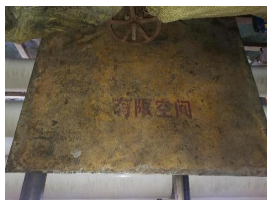
图 16 3#好氧池人孔盖板
